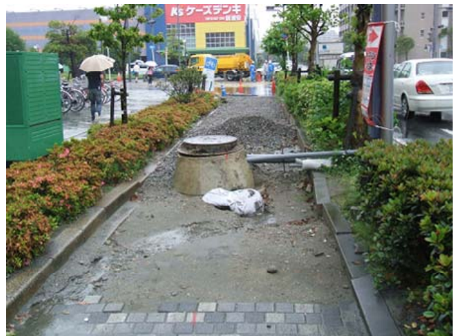
P-9 スーパー近傍の歩道のマンホールの変状
