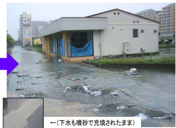
P-7 P-6の3ヶ月後(歩道の変状, 建物の不同沈下)
