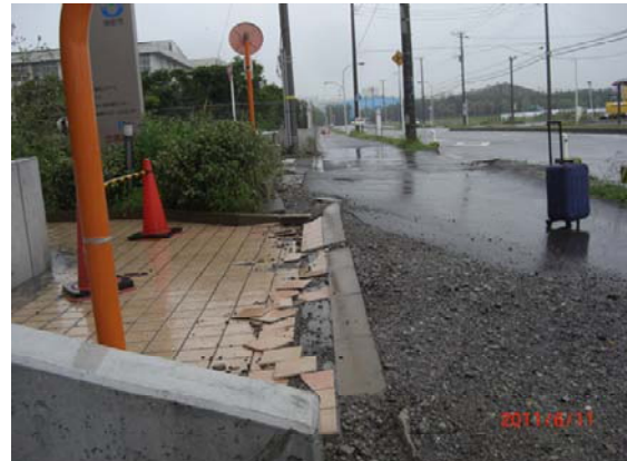
P-11 高洲地区老人ホームの入口の変状
