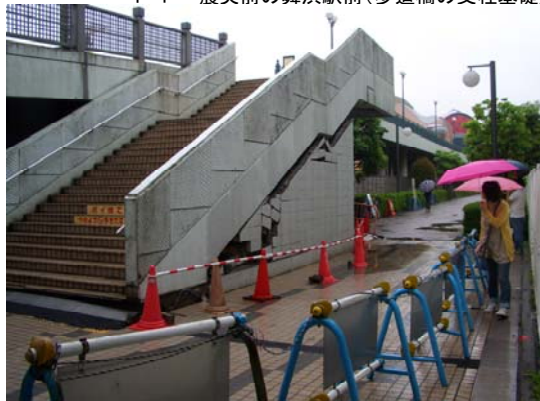
P-2 JR舞浜駅前の歩行者用通路階段側壁部の破損状況
