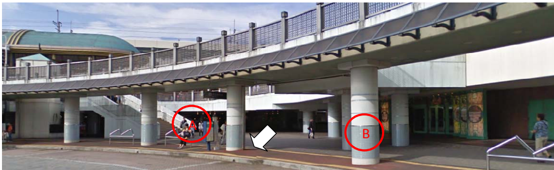
P-1 震災前の舞浜駅前(歩道橋の支柱基礎周辺が少し浮き上がっている(矢印箇所)ようです) 1)
