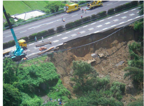
P-1 東名高速道路の崩壊状況(NEXCO 中日本 HP)
